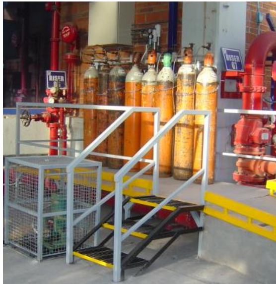
Figura 65 Almacenaje de Cilindros de HCs
