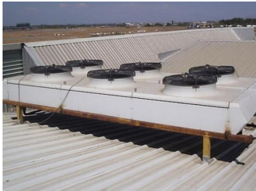
Figura 4 Evaporador Enfriados por Aire
